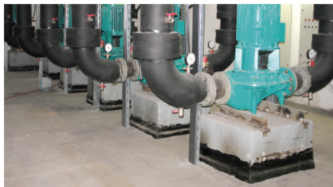
Виброизоляция магистральных насосов
