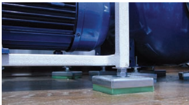
Виброизоляция насосного оборудования
